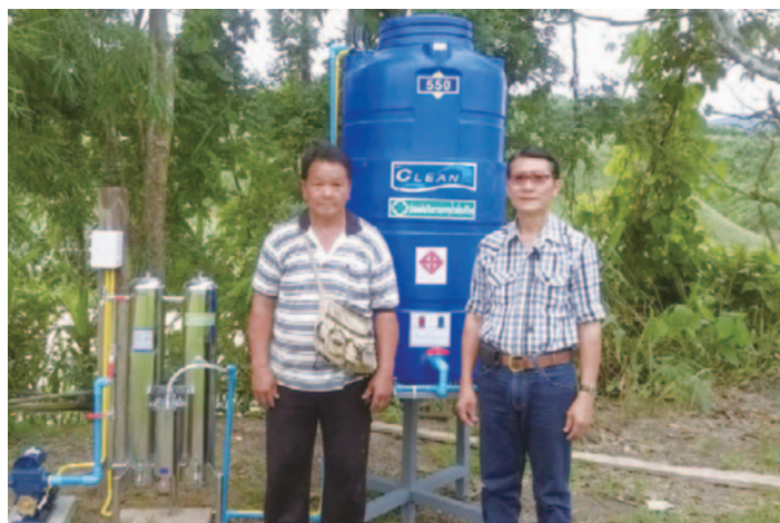
支援によって設置された浄水フィルターの装置
