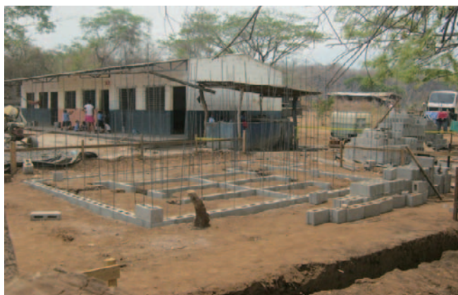
在エルサルバドル日本大使館の助成金により建設中の小学校
