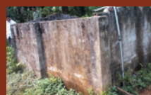
壊れた幼稚園の水タンク
