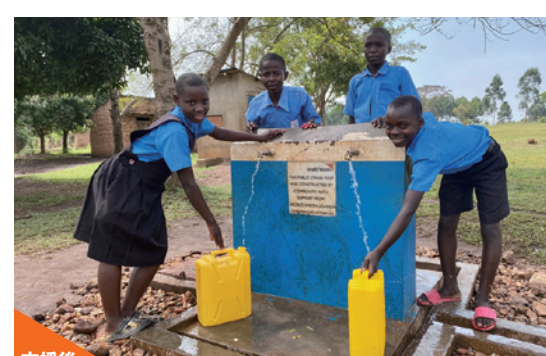
支援後 学校に設置された水道
