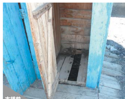
支援前 古く、衛生的でないトイレ
