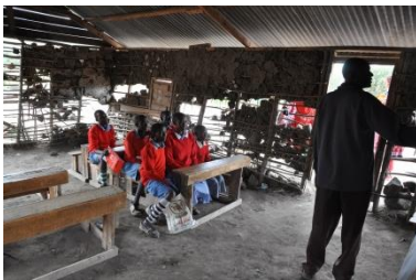
支援地域の小学校の様子。 壁が崩れかけています
